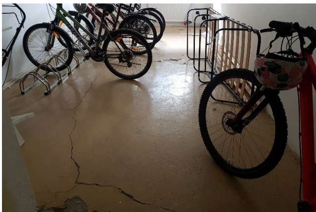
MYND 16: Sprungur í gólfi í hjólageymslu/þurrkherbergi.
