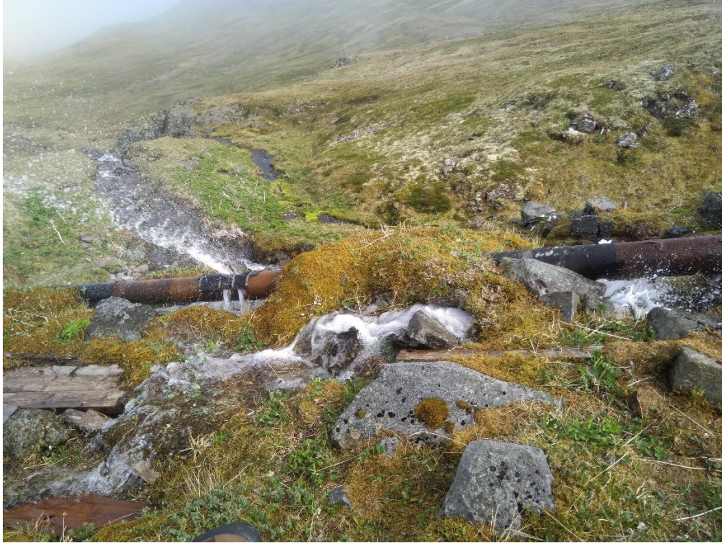
Vatnsleki úr aðrennslispípu.
