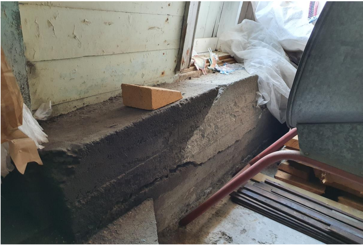
Fyrsta hæð, sökkulveggur steypur ofan á gólfplötu og innan á fótstykki, farinn að brotna við norð-austurhorn hússins
