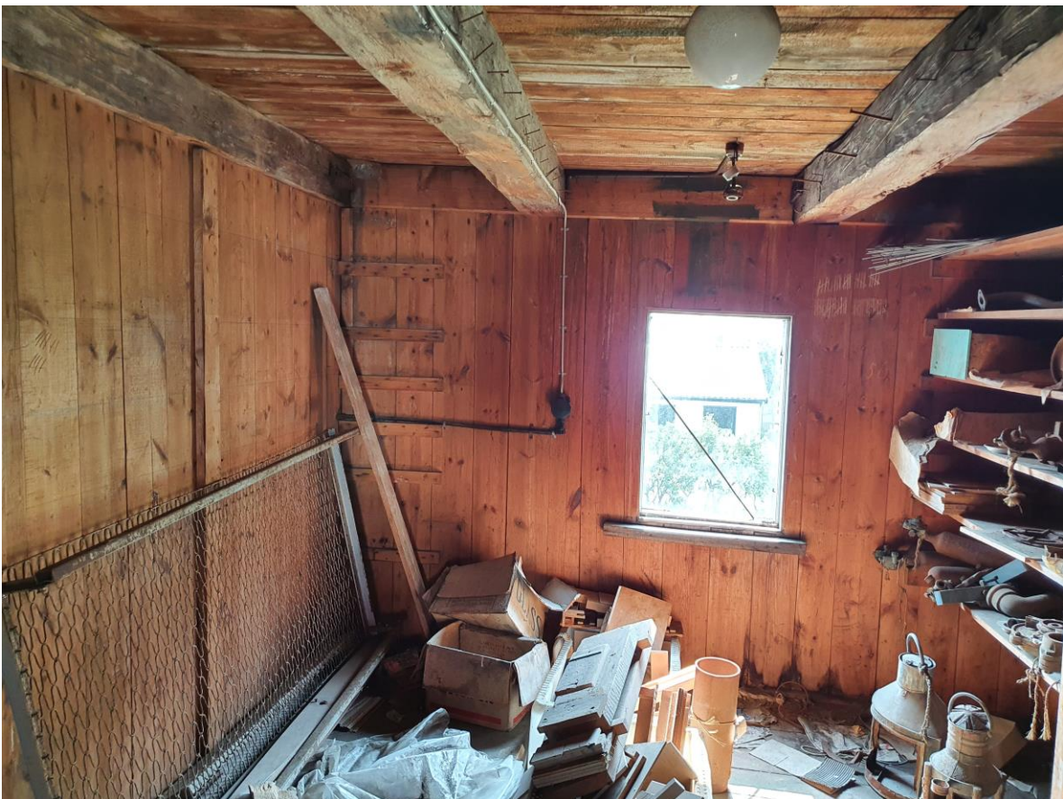
Önnur hæð, klæðning innan á útveggjum farin að skemmast við glugga og önnur op, grindin einnig farin að skemmast á sömu stöðum.
