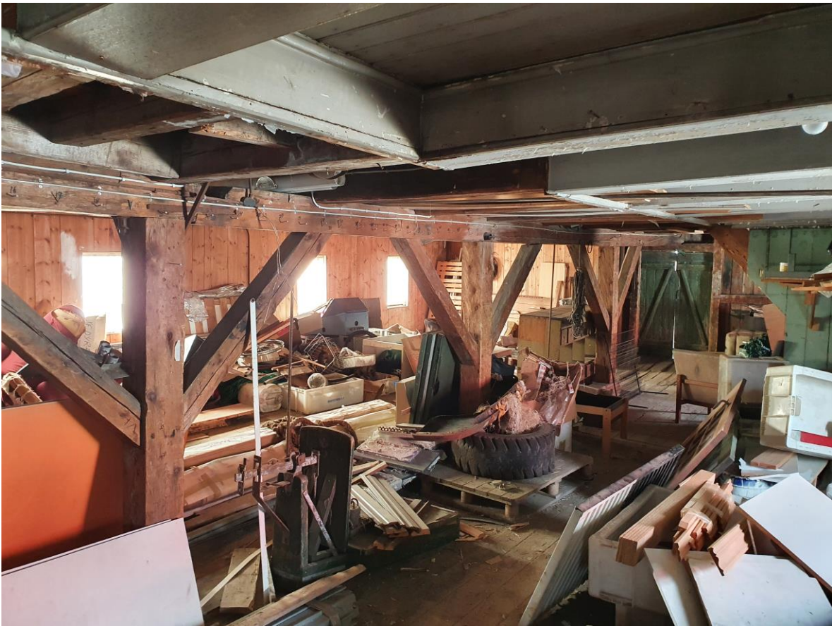
Önnur hæð, loftbitar hafa sigið, klæðning innan á útveggjagrind í hluta hæðarinnar
