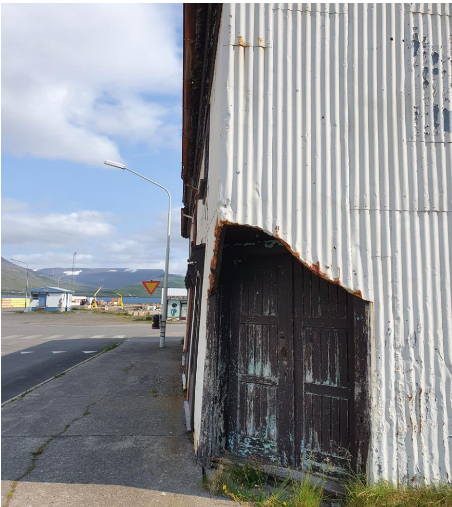
Norðurveggur hallar út
