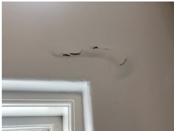
Rakaskemmdir veggja 2. hæð
